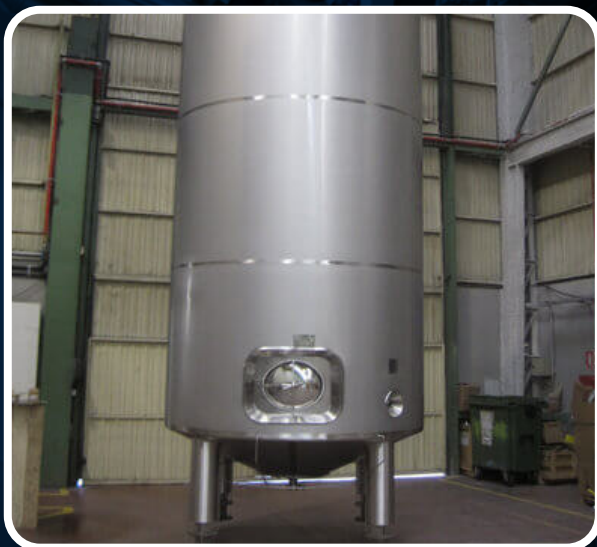
TANQUE PARA AGUA HELADA
