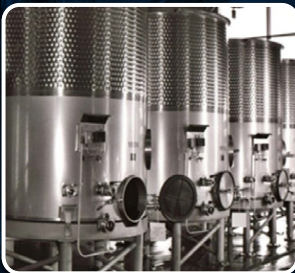
TANQUE PARA AGUA CALIENTE
